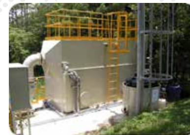
污水處理廠臭味去除系統
